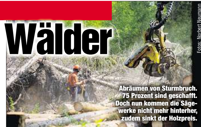
Abräumen von Sturmbruch. 75 Prozent sind geschafft. Doch nun kommen die Sägewerke nicht mehr hinterher, zudem sinkt der Holzpreis.
