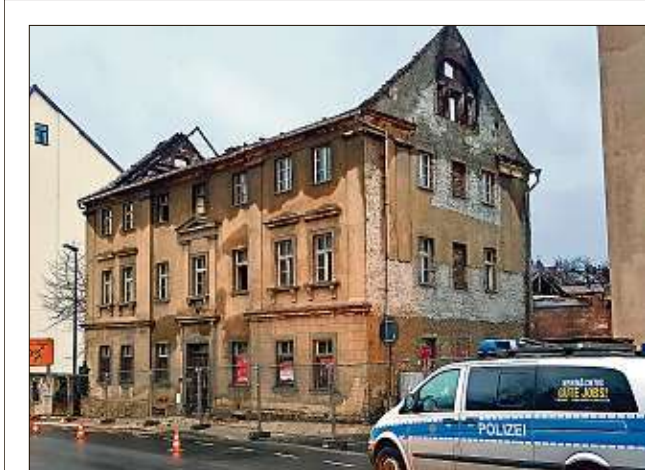
Wegen eines Bröckelhauses ist der Promenadenring in Löbau jetzt halbseitig gesperrt.
