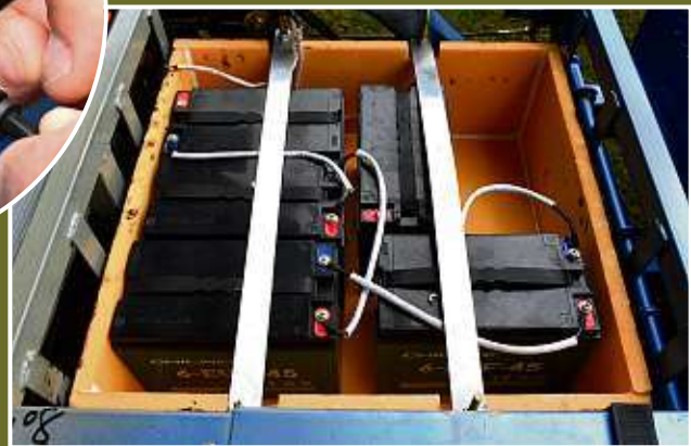
Die Gel-Batterien im Unterboden bunkern die Energie für eine Strecke von bis zu 60 Kilometern.
