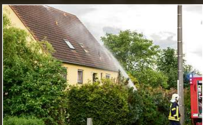
In Dittersbach schlug der Blitz in ein Dach ein.
