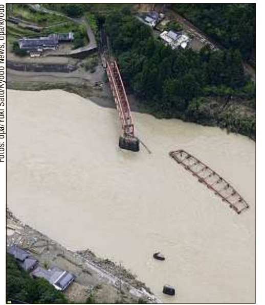
Eine Brücke in Yashiro wurde vom Fluss Kuma zerstört. ►
