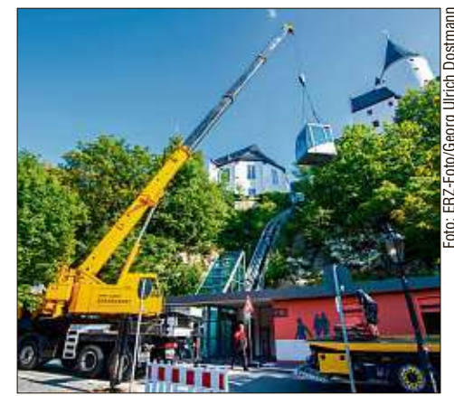
Am Fuße der Schwarzenberger Altstadt verlädt ein Kran die Schrägaufzugs-Kabine auf einen Tieflader.
