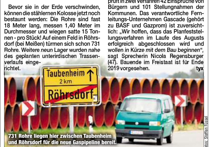
731 Rohre liegen hier zwischen Taubenheim und Röhrsdorf für die neue Gaspipeline bereit.
