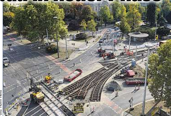
So sieht der Albertplatz derzeit aus. Die neue Gleiskonstruktion wiegt 13 Tonnen und wird nachts in Einzelteilen zur Baustelle geliefert.
