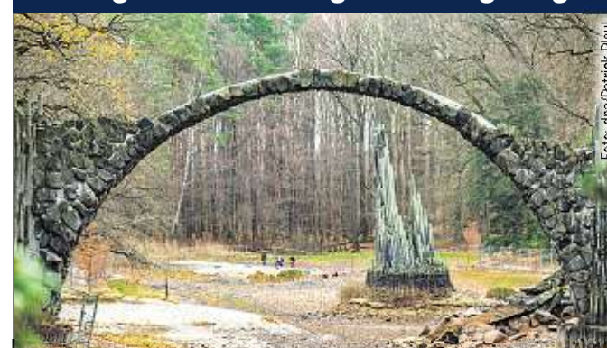
Ungewöhnlicher Anblick: Das Ensemble aus Rakotzbrücke, Grotte (rechts) und Orgel liegt während der Sanierung auf dem Trockenen.
