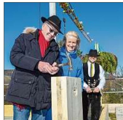
Rüdiger Schumann schlägt auf dem Dach den symbolischen Nagel zum Richtfest ein.
