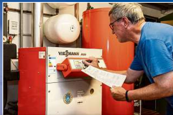
Ältere Gasheizungen verbrauchen in der Regel mehr Energie als neuere Modelle.
