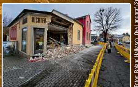
Durch den Aufprall wurde die Substanz des Hauses, in dem die Bäckerei ist, massiv beschädigt. Ein Gutachten ergab allerdings, es ist zu retten. Im Sommer nächsten Jahres soll alles wieder wie neu aussehen ...
